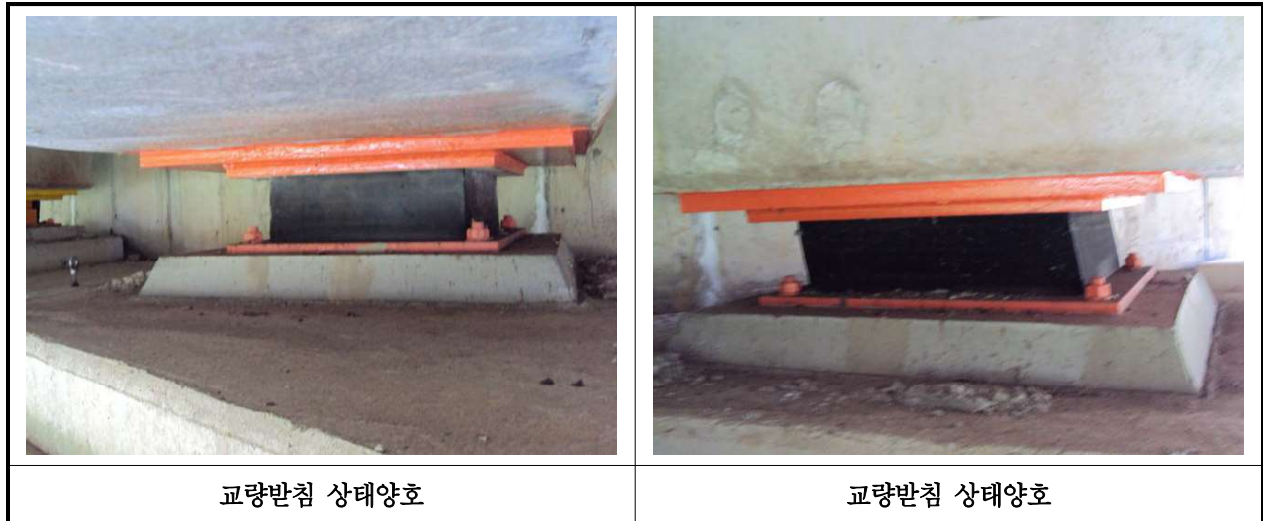
【사진 41.3.11】 교량받침 손상현황
