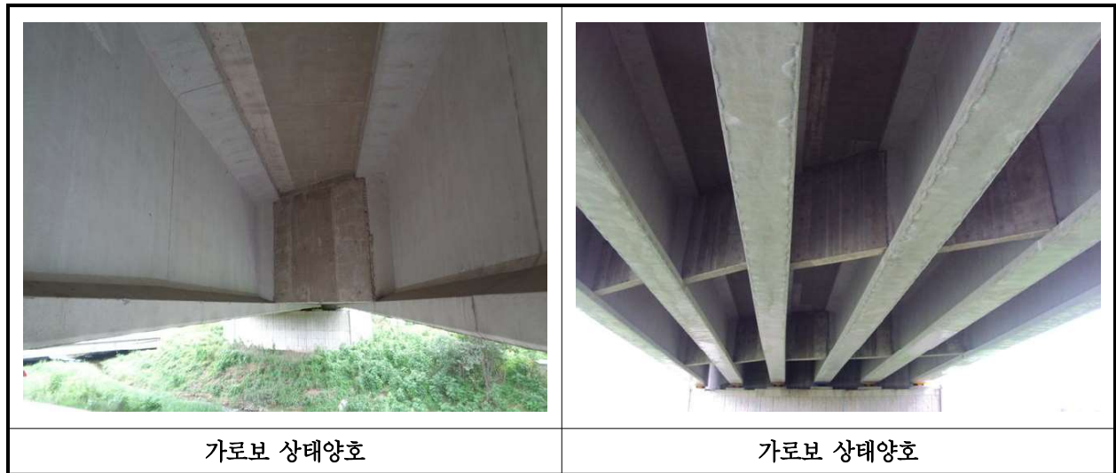
【사진 41.3.7】 가로보 손상현황
